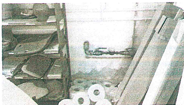
Zdj. 7-5 Wejście instalacji wodnej z wodomierzem na ścianie północnej pomieszczenia 0/3 Archiwum Małego. Złuszczenia tynku na wysokości około 30 cm. Miejsce przejścia rury wodociągowej mokre.
