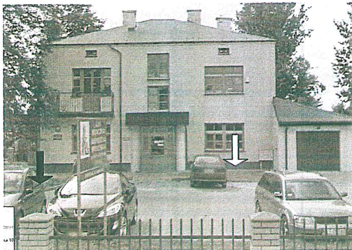
Zdj. 7-2 Elewacja frontowa (północna) budynku z wejściem głównym. Strzałką o kolorze białym oznaczono miejsce wykonania odkrywki fundamentów zaś czarną lokalizację studzienki kanalizacji ogólnospławnej.
