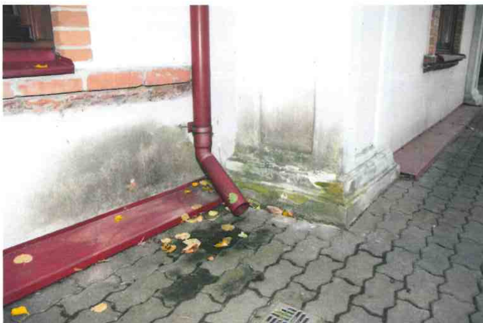
Fot.11. Na elewacji widoczne glony, spowodowane sprzyjającymi warunkami wilgotnościowymi
