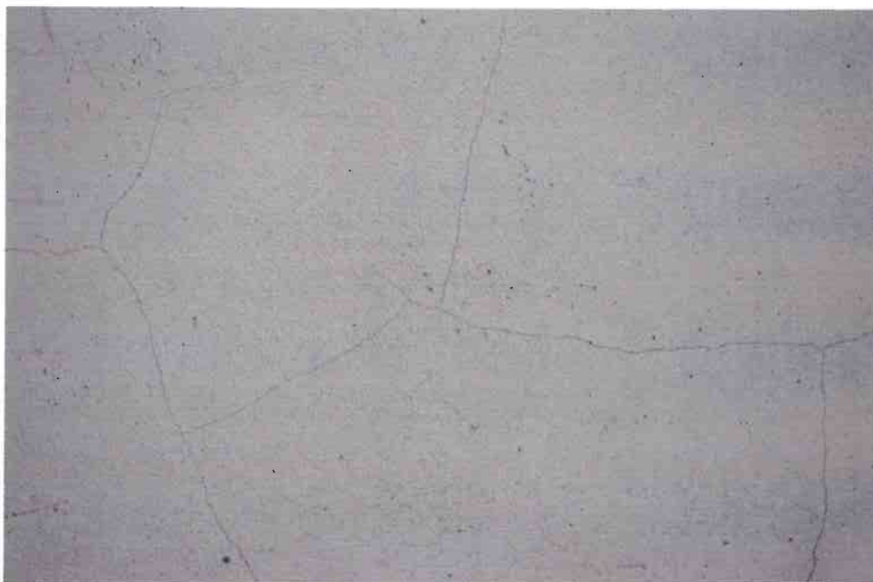
Fot.8. Spękany i odspojony tynk
