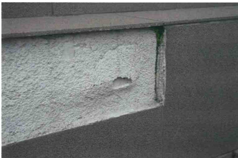
Fot.4. Miejscowe ubytki wyprawy tynkarskiej
