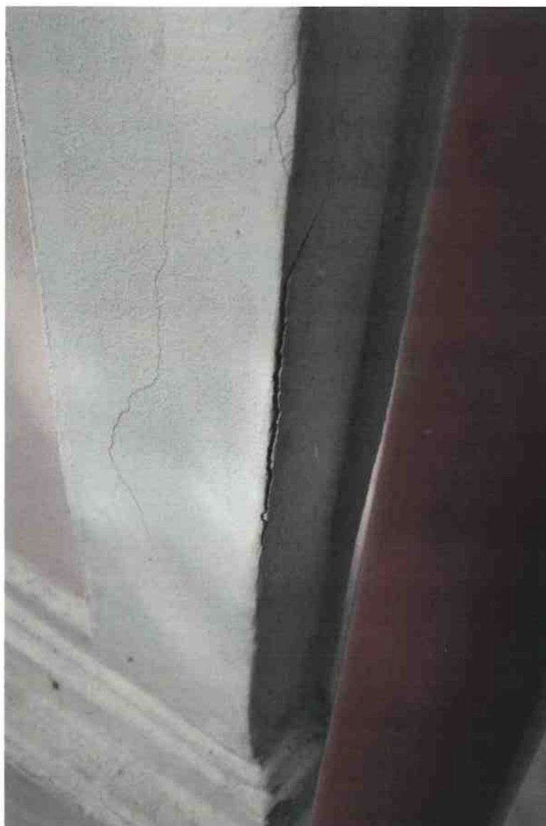
Fot.12. Uszkodzenie tynku od wilgoci i zasolenia
