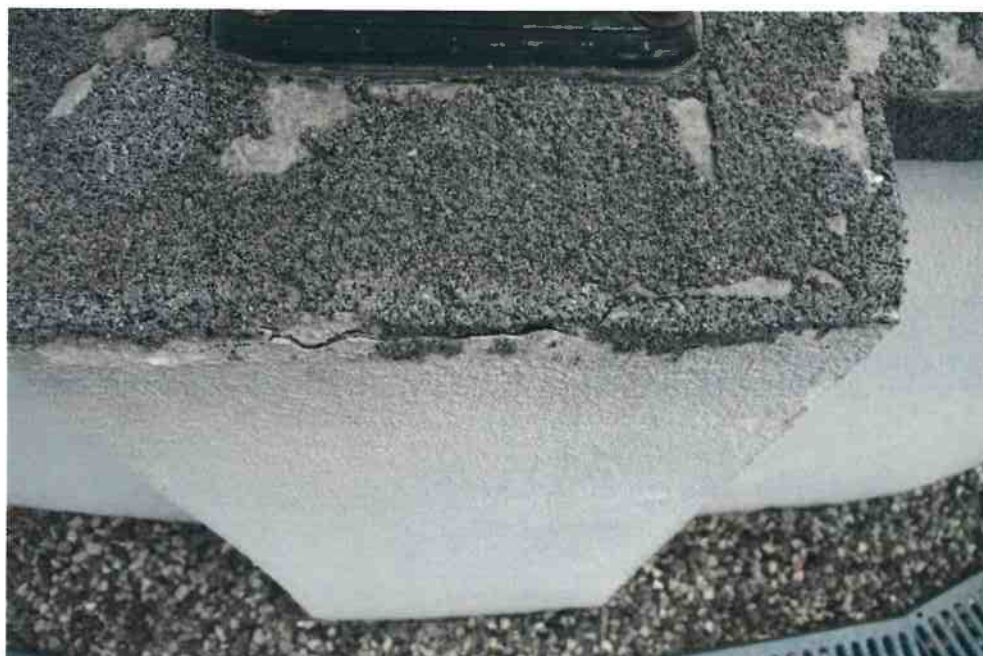
Fot.15. Odspojenie tynku i miejsce przedostawania się wody między tynk a mur
