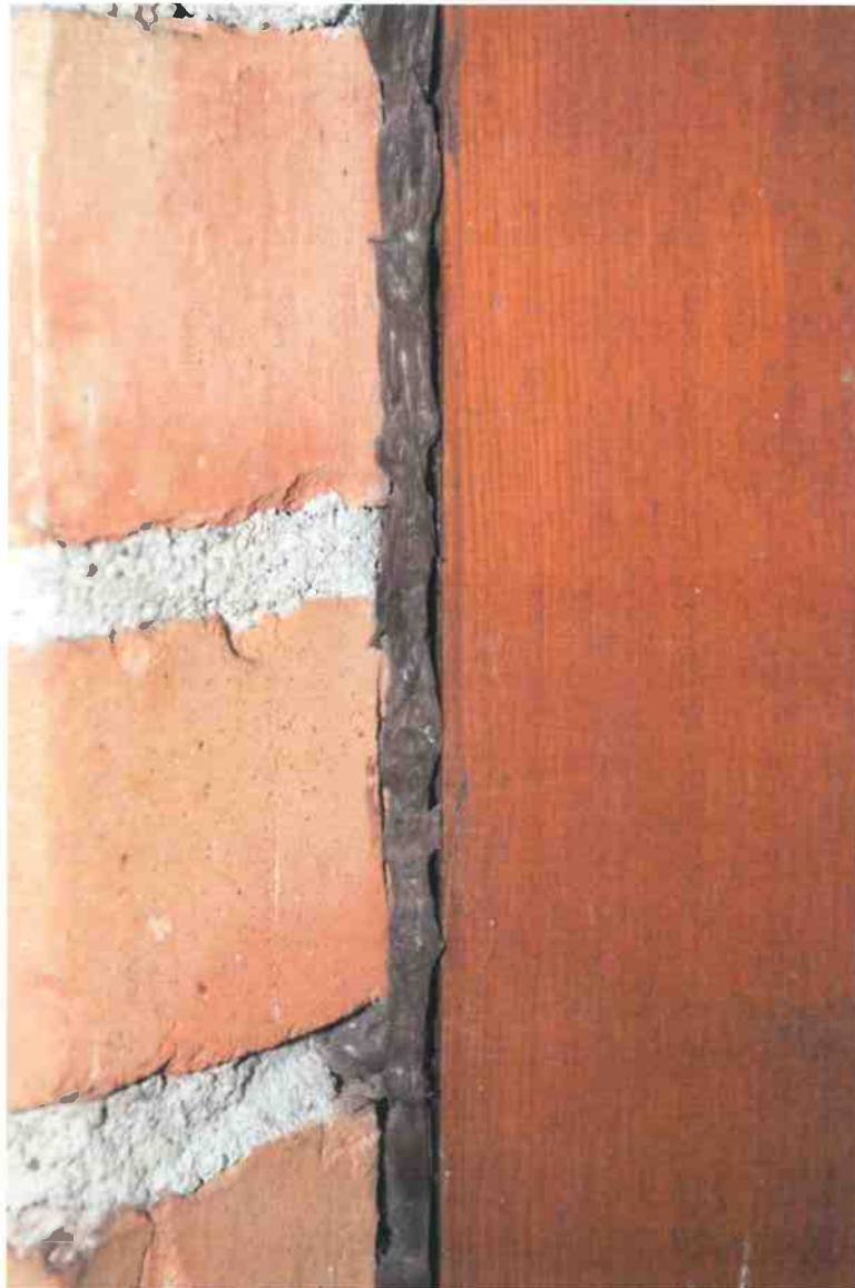
Fot.13. Niedbałe wypełnienie styku okna i ościeży silikonem
