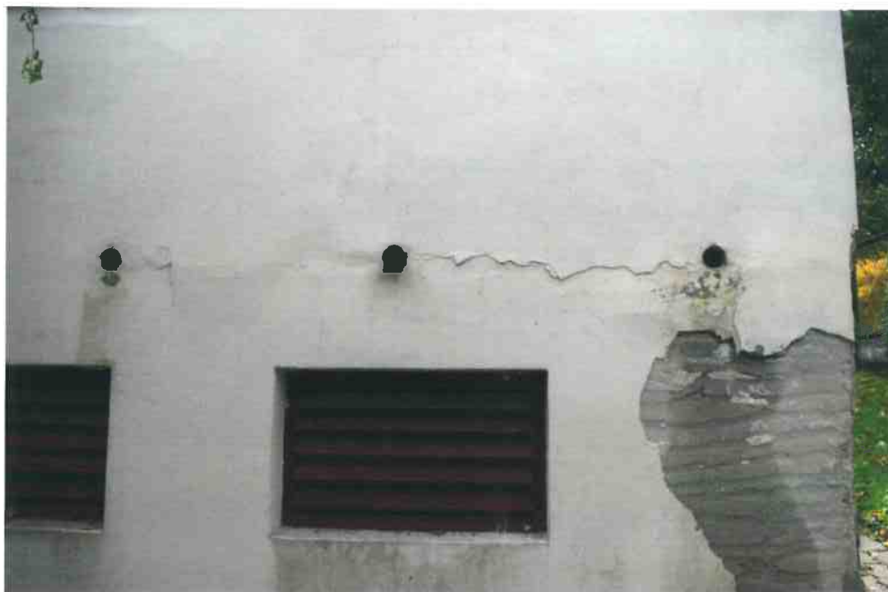
Fot.26. Degradacja tynku i muru spowodowana przeciekami od tarasu, miejscowy rozwój glonów
