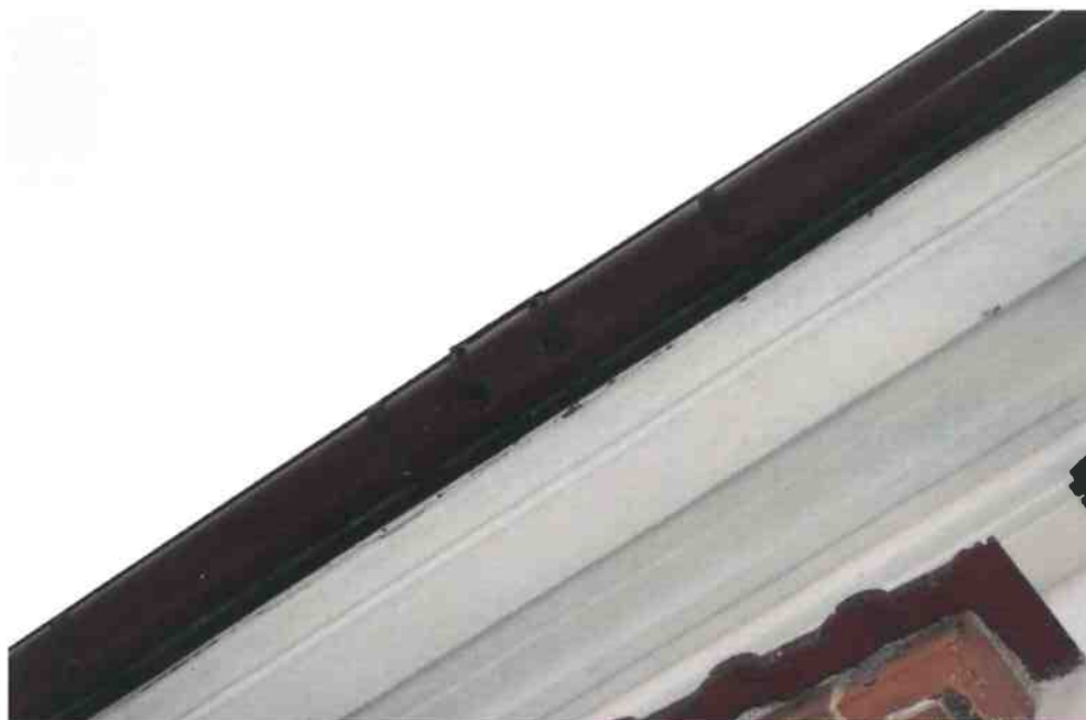
Fot.22. Miejsce przecieku, dotyczy zdjęcia nr 21.
