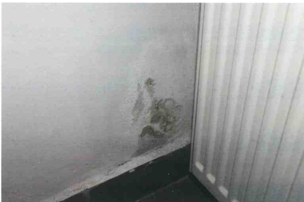
Fot.2. Miejscowa krystalizacja soli na powierzchni tynku
