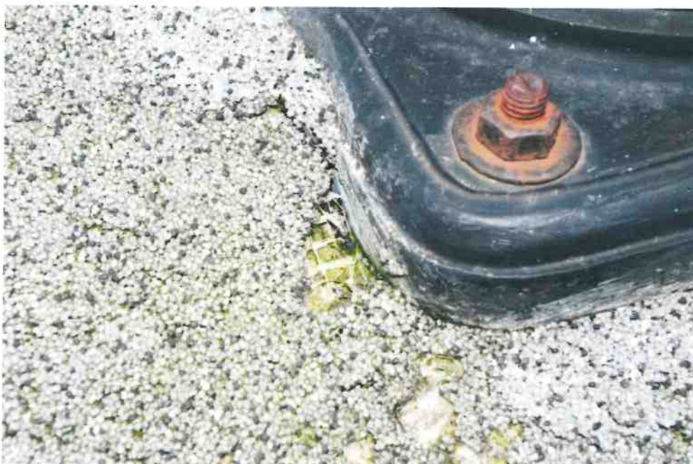
Fot.18. Pęknięcia w miejscach montażu latarni, woda swobodnie przedostaje się do muru i go zawilgaca
