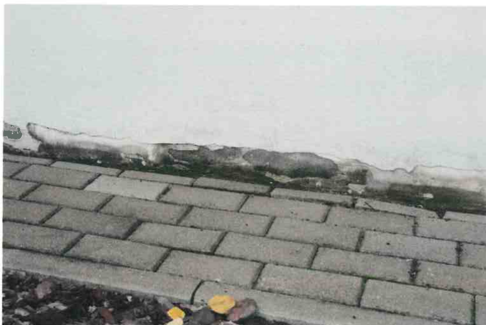
Fot.14. Uszkodzenie szpachli nad opaską z kostki oraz miejscowy rozwój glonów
