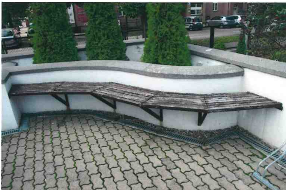
Fot.17. Uszkodzona farba i struktura drewna na ławkach od warunków atmosferycznych
