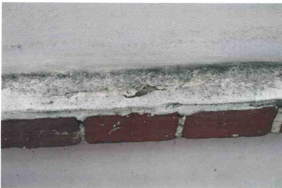
Fot.5. Uszkodzenia warstwy tynku nad wypustem ceglany
