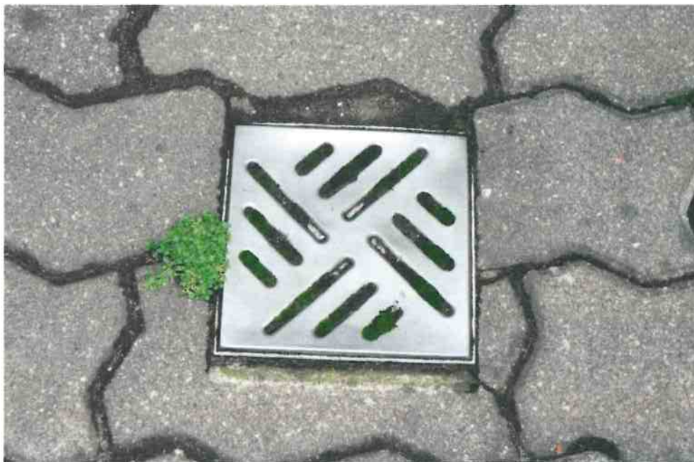
Fot.10. Zatkana kratka odprowadzająca wodę z rury spustowej
