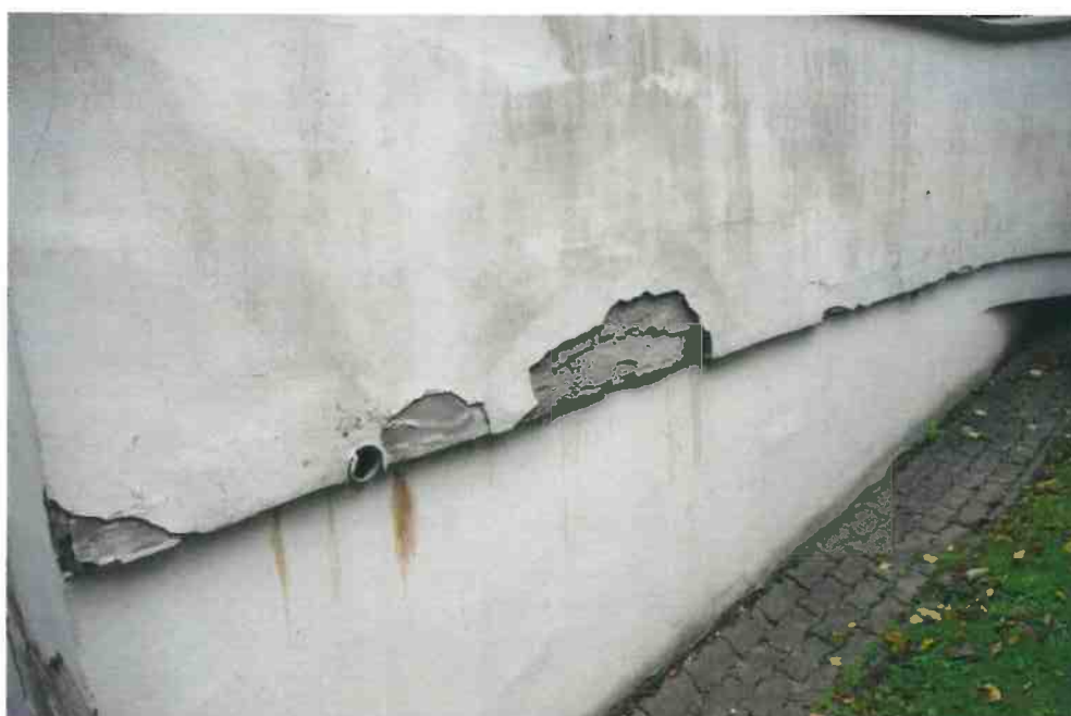
Fot.27. Duże uszkodzenia tynku spowodowane przeciekającym tarasem, rozwój glonów
