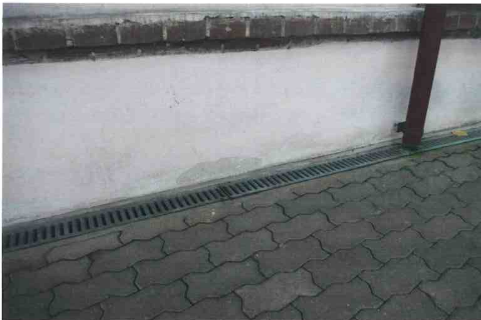
Fot.3. Miejscowe ubytki farby i szpachli nad kostką
