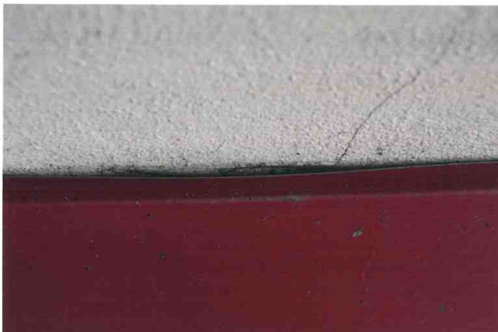
Fot.9. brak uszczelniania między obróbką blacharską a murem
