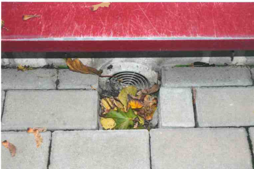
Fot.20. kratka wentylacyjna w zagłębieniu po założeniu kostki brukowej i podniesieniu terenu. Może powodować przedostawanie się wody pod budynek podczas obfitych opadów deszczu.
