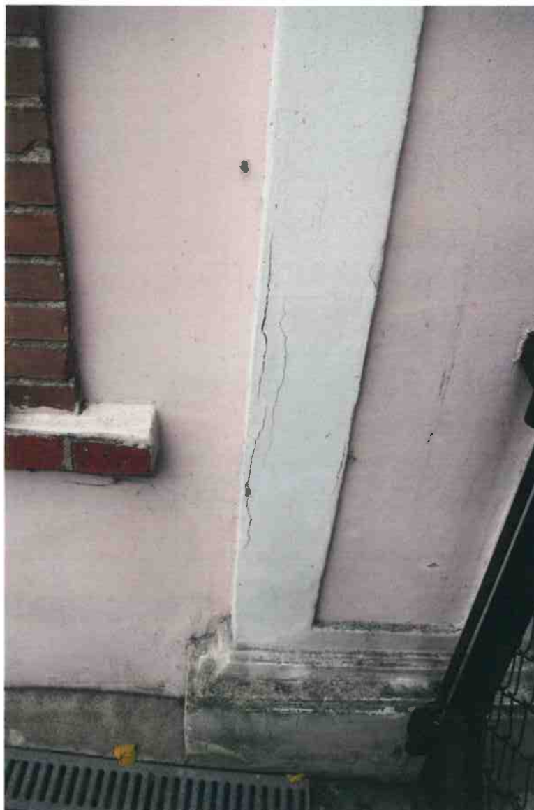
Fot.7. Uszkodzenie tynku od wilgoci i zasolenia
