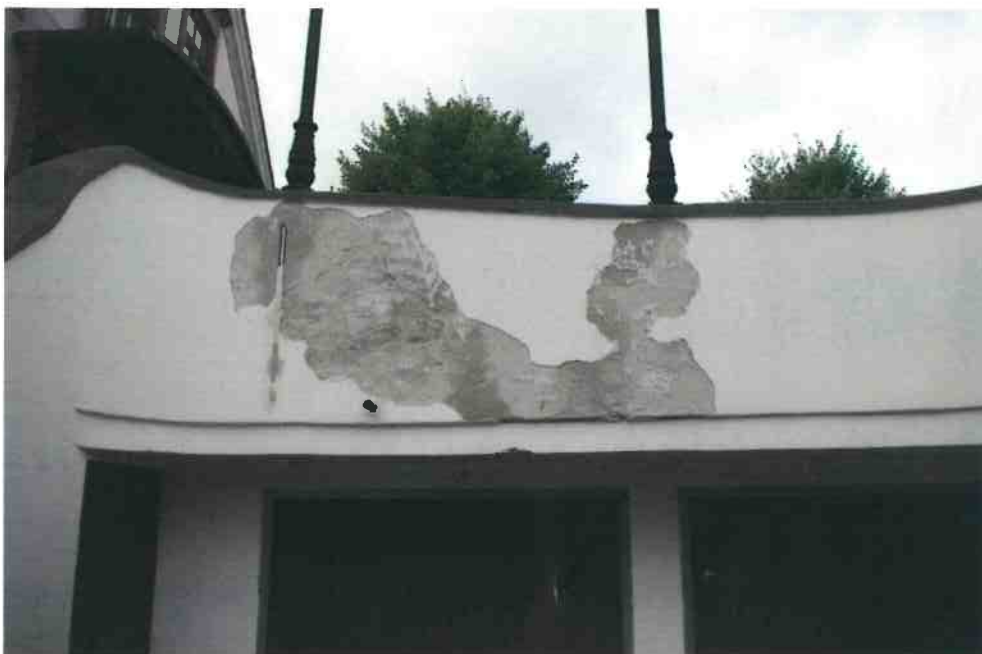
Fot.24. Odpadający tynk spowodowany pęknięciami i przeciekami w miejscu mocowania Lamp, przedstawiono na zdjęciach nr 18,19
