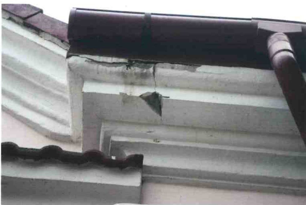
Fot.6. Uszkodzenie gzymsu i nieszczelność rynny
