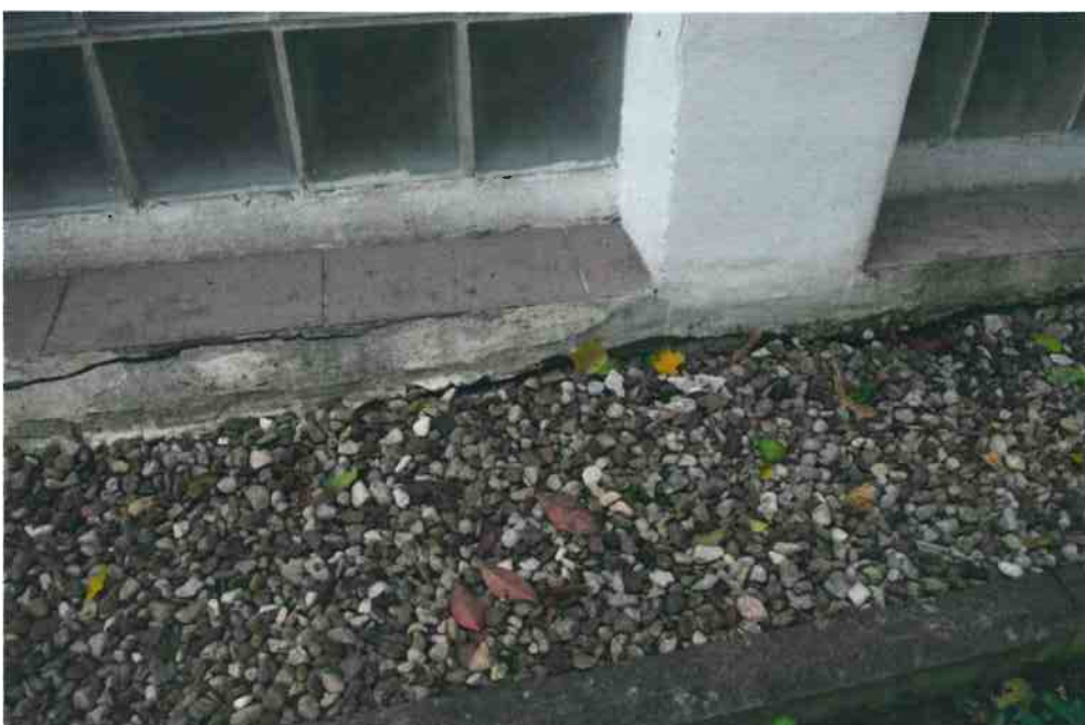
Fot.25. Uszkodzenie tynku pod parapetami
