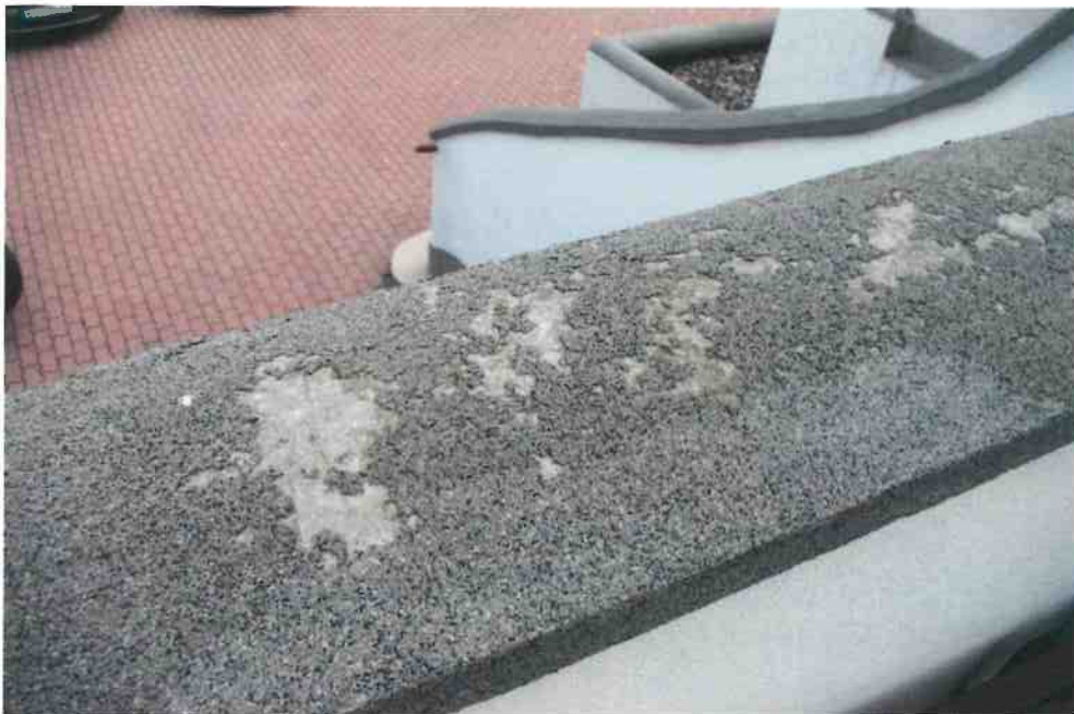
Fot.16. Znaczne uszkodzenie żywicy na murku
