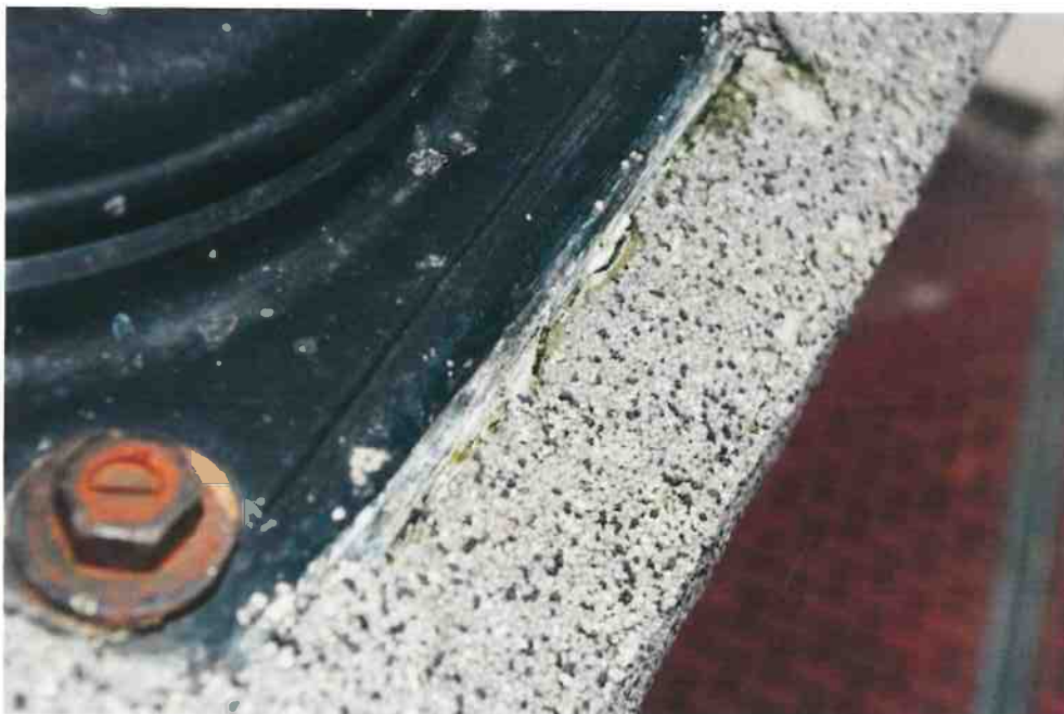
Fot.19. Pęknięcia w miejscach montażu latarni, woda swobodnie przedostaje się do muru i go zawilgaca
