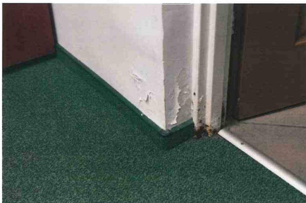
Fot.23. Widoczna krystalizacja soli na murze wewnątrz budynku, oraz korozja ościeżnicy metalowej od wilgoci
