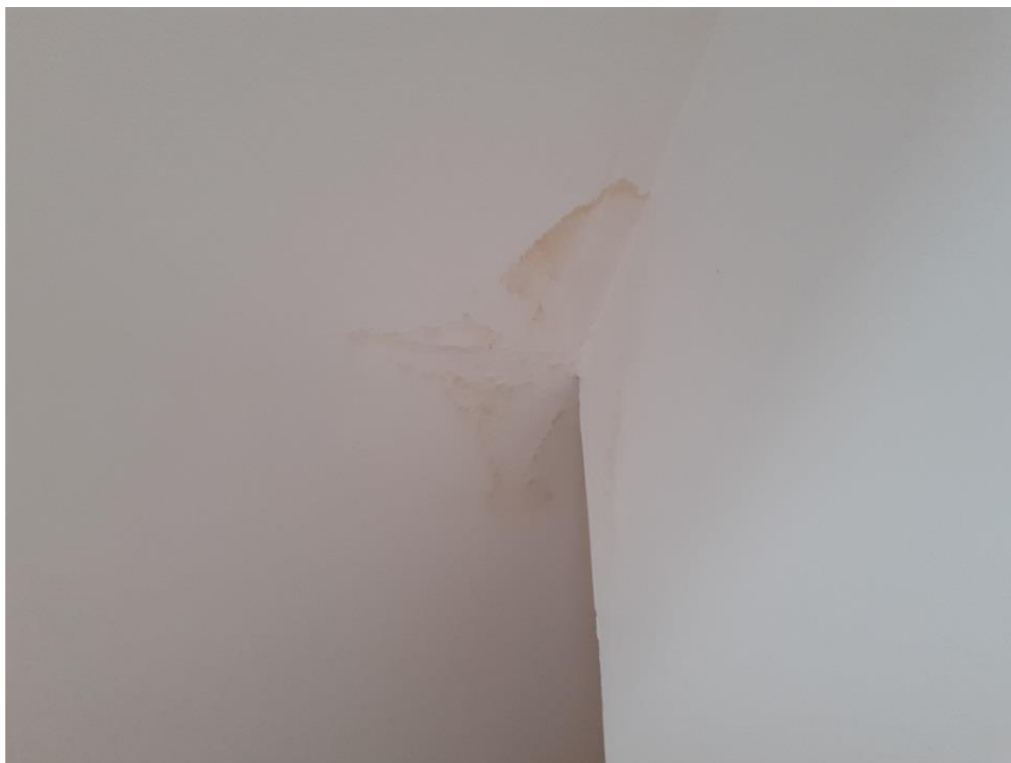
Fotografia nr 5 (pokój 207 zacieki przy kominie)
