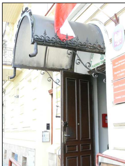
Zdjęcie nr 3. Widok markizy nad drzwiami, niestety nie chroni przed opadami atmosferycznymi powierzchni drewnianej części dolnej.
