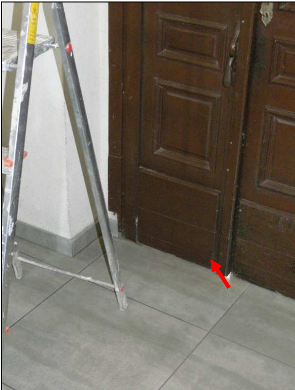
Zdjęcie nr 4. Stolarka drzwiowa jest wypaczona. Po zamknięciu drzwi uwidaczniają się prześwity. Strzałka czerwona wskazuje to miejsce.
