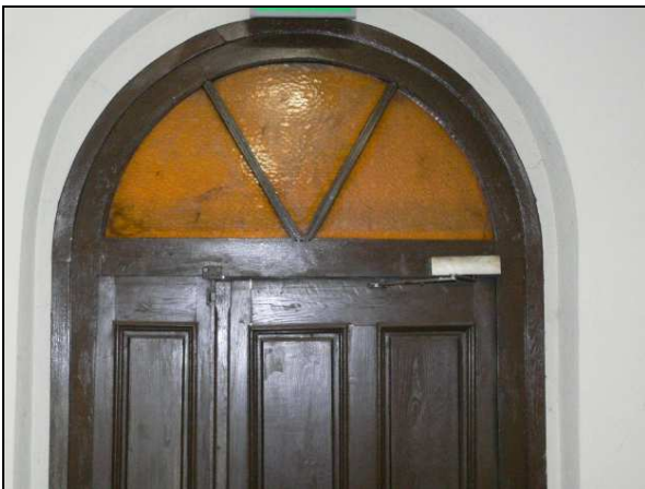
Zdjęcie nr 5. Widok naświetla. Zgodnie z przepisami przeciwpożarowymi naświetle powinno się otwierać automatycznie po uzyskaniu sygnału z centrali pożarowej, która otrzymuje sygnał od czujki dymnej. Celem jest aby dym unosił się nad podłogą na wysokości około 180 cm.
