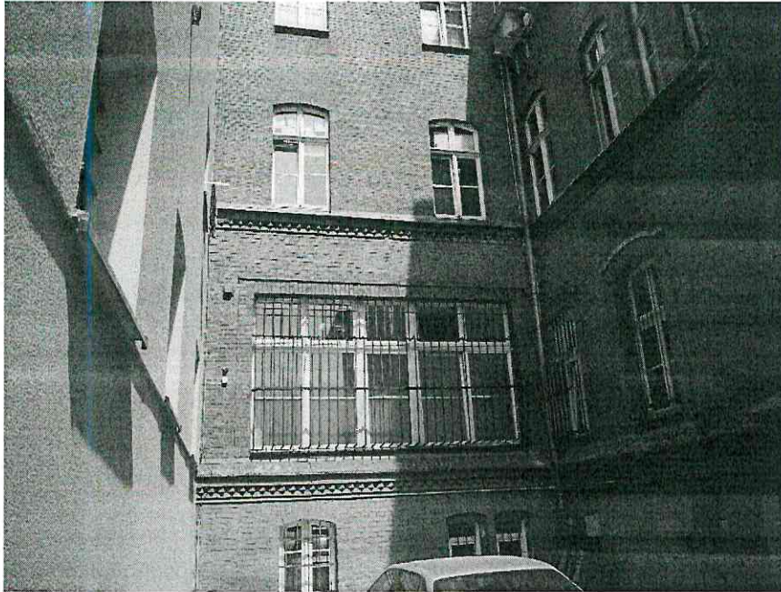
Fot. 3 – Kraty okienne do konserwacji
