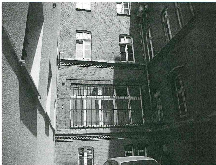
Fot. 3 – Kraty okienne do konserwacji
