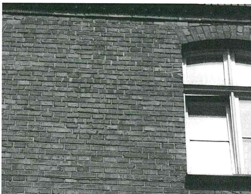
Fot. 2 – Drobne ubytki spoin warstwy fakturowej
