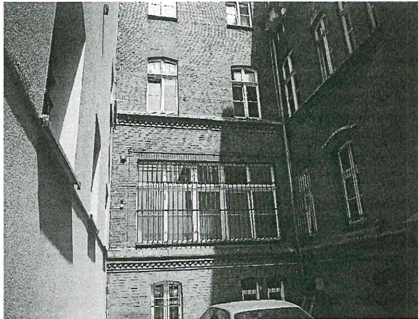
Fot. 3 – Kraty okienne do konserwacji
