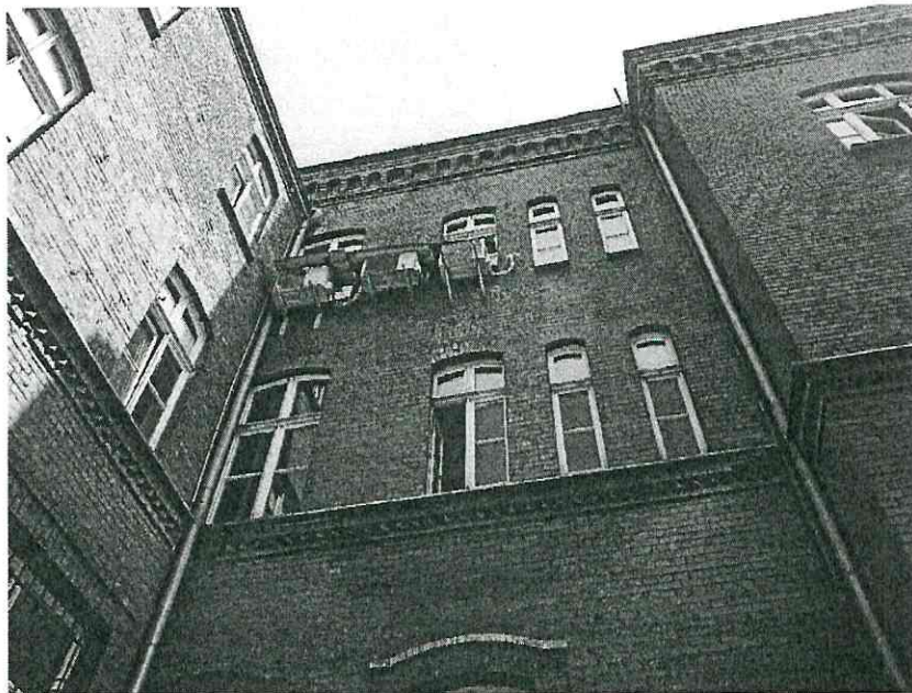
Fot. 4 – Osłona klimatyzatorów do wymiany
