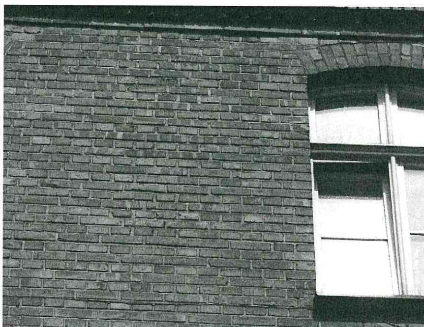
Fot. 2 – Drobne ubytki spoin warstwy fakturowej
