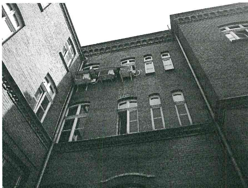
Fot. 4 – Osłona klimatyzatorów do wymiany
