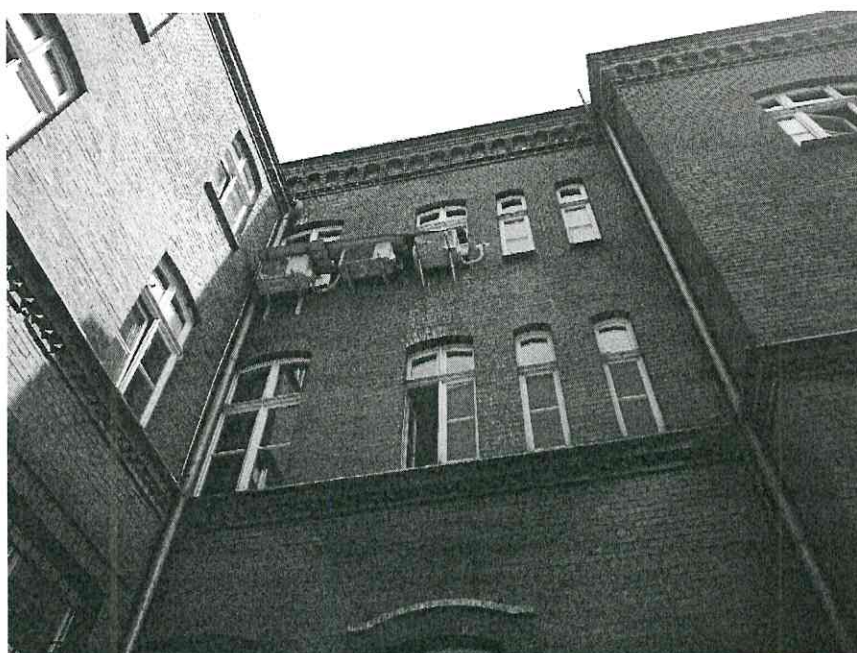
Fot. 4 – Osłona klimatyzatorów do wymiany
