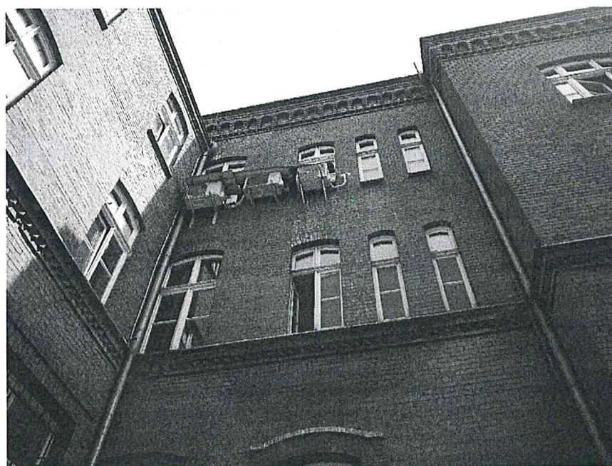
Fot. 4 – Osłona klimatyzatorów do wymiany
