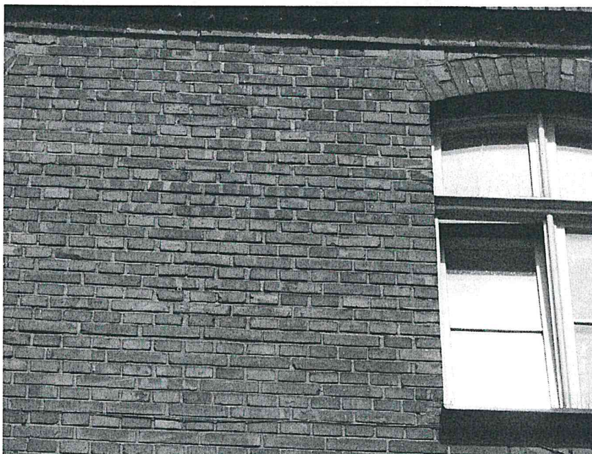
Fot. 2 – Drobne ubytki spoin warstwy fakturowej
