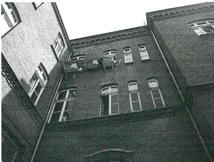
Fot. 4 – Osłona klimatyzatorów do wymiany
