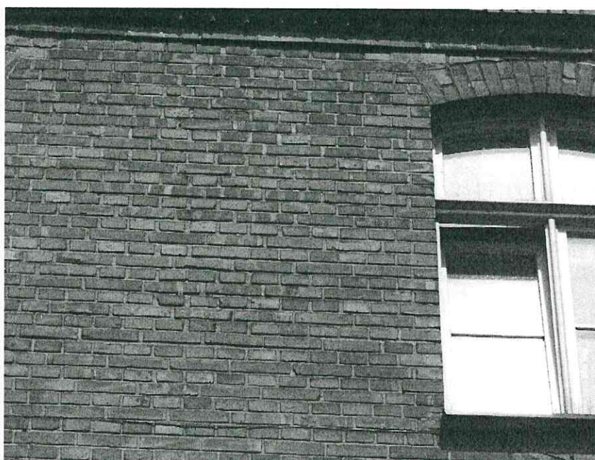
Fot. 2 – Drobne ubytki spoin warstwy fakturowej
