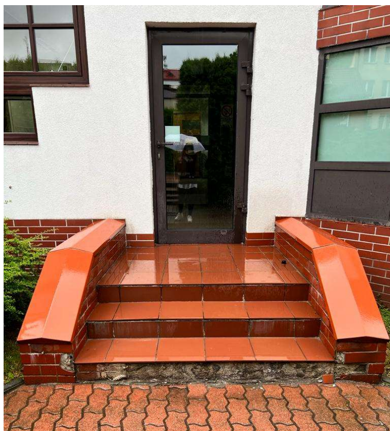
Fot.6. Widok bocznych schodów do budynku od strony południowo-wschodniej wykończonych płytkami gresowymi - przeznaczone do remontu
