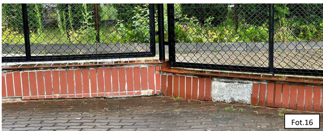
Fot. 12.-Fot.16. Widok pękniętych płytek klinkierowych na powierzchniach cokołów ogrodzenia oraz na słupach ogrodzeniowych. Widoczne znaczne pęknięcia na betonowych cokołach oraz odspojenia od powierzchni betonowych warstw wykończeniowych
