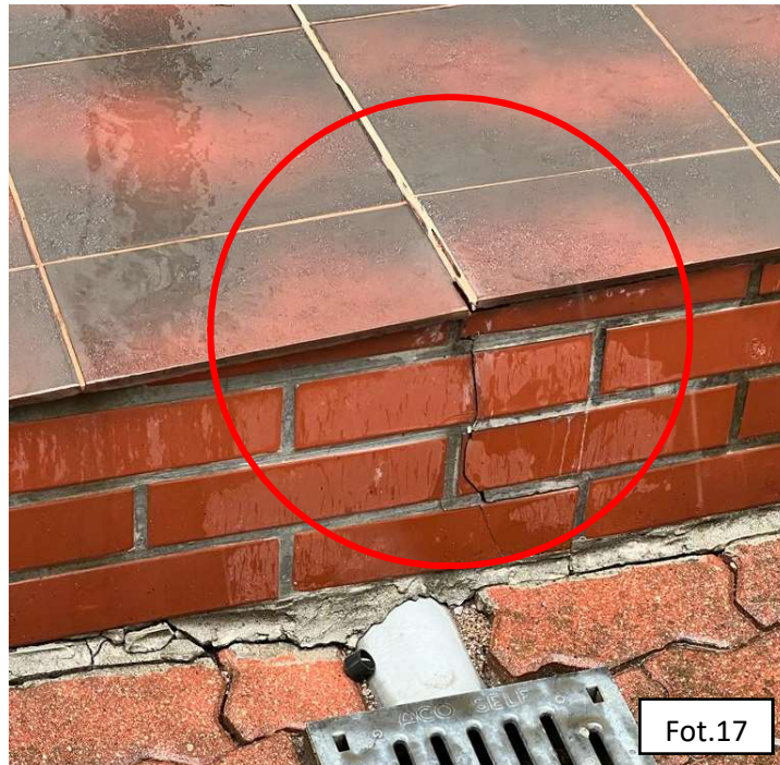
Fot. 17. Widok pęknięcia pionowego na pochylni z lewej strony budynku
