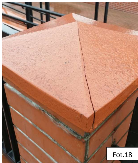
Fot. 18. Widok pękniętej czapki na słupie ogrodzeniowym
