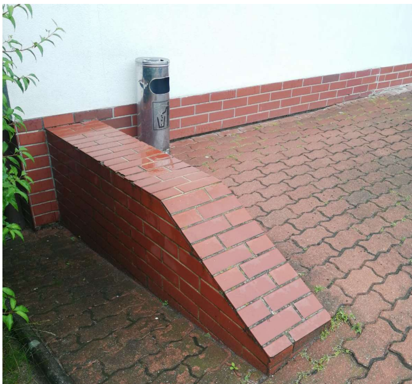
Fot.9. Murek oporowy wykończony płytkami klinkierowymi od strony parkingu – północno-wschodniej - przeznaczone do remontu
