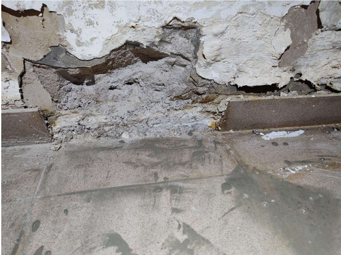
Zdjęcie 11. Penetracja wody przez ścianę
