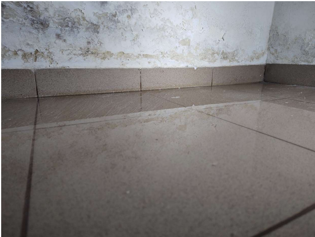
Zdjęcie 3. Zalany narożnik wodą w magazynie po prawej strony kotłowni
