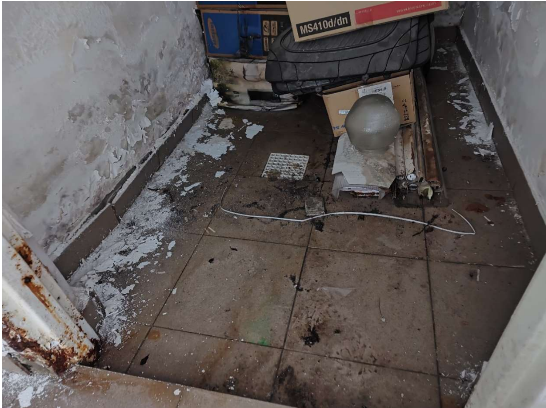
Zdjęcie 8. Widok zawilgocenia w pom. pod schodami
