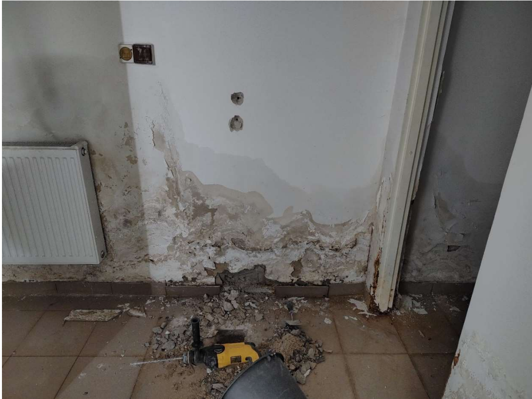
Zdjęcie 9. Lokalizacja przewiertu przez zawilgoconą ścianę i zasięg zawilgocenia jej.
