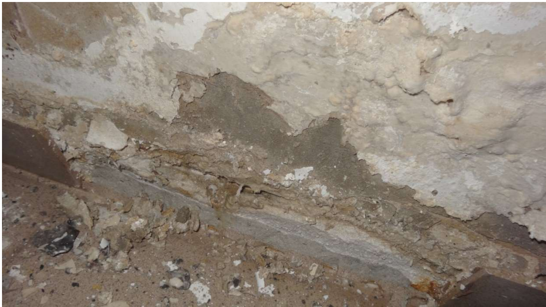
Zdjęcie 6. Miejsce sączenia się wody ze ściany
