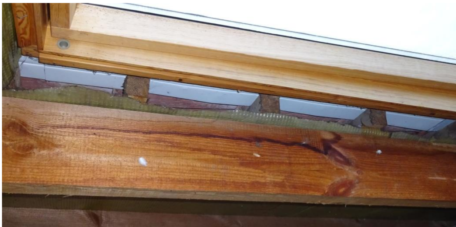
Foto nr 1-widoczne ślady zacieku, łąty mocowane do krokwi
