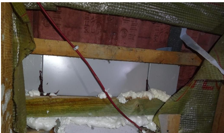
Foto nr 3- zerwana folia dachowa, doszczelnienie pianką nieszczelności przy kominie
