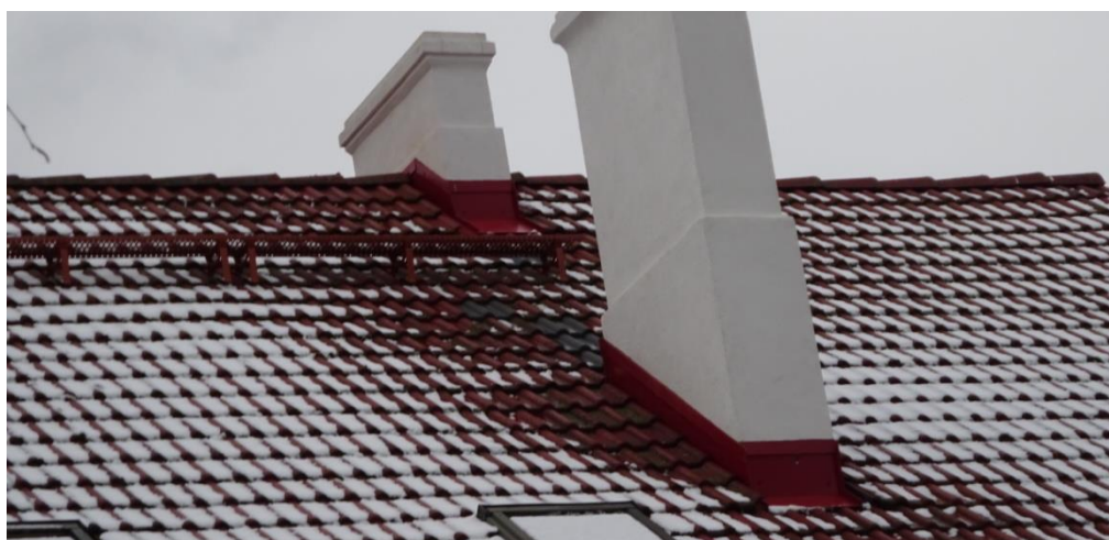
Foto nr 8- widoczna miejscowa wymiana dachówek, widoczne porosty na dachówkach i gąsiorach
