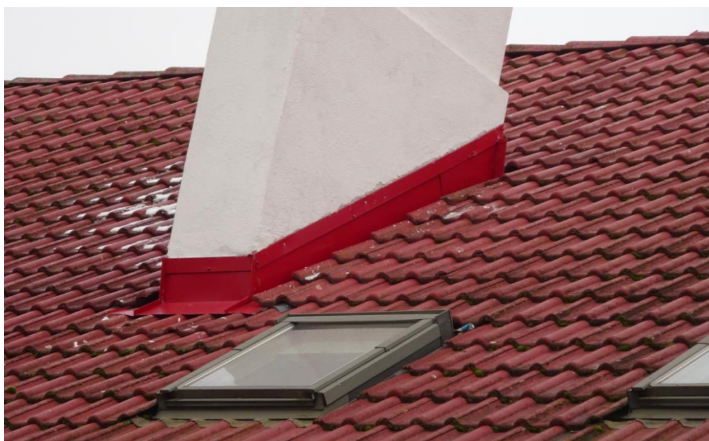
Foto nr 8- widoczne porosty na dachówkach i gąsiorach
