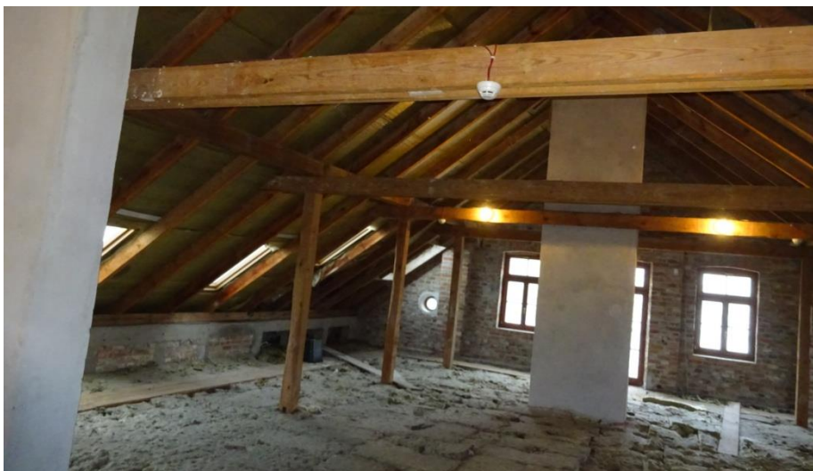
Foto nr 2- ogólny widok poddasza nieużytkowego, brak podłogi
