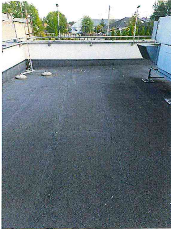
Zdjęcie 5. Mała wysokość izolacji ściany attyki
