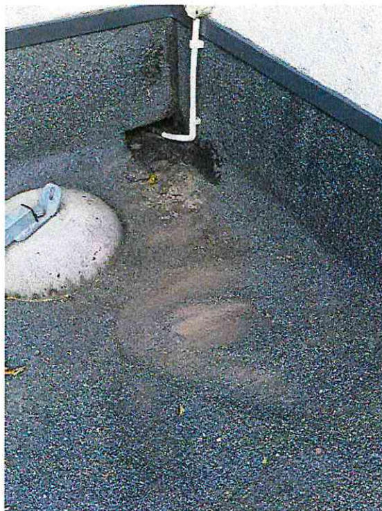
Zdjęcie 4. Odprowadzenie wody i mała wysokość izolacji ściany attyki
