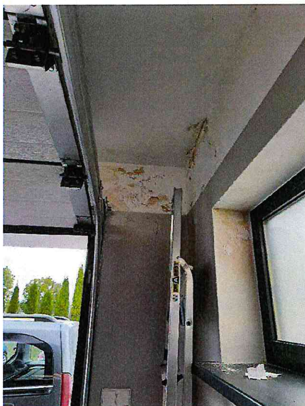
Zdjęcie 2. Zacieki pod narożami tarasu
