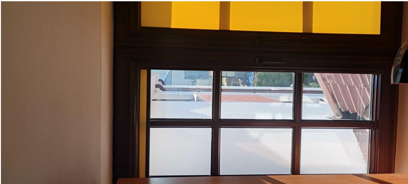
Zaciek w pomieszczeniu 212 zdjęcie nr 3
