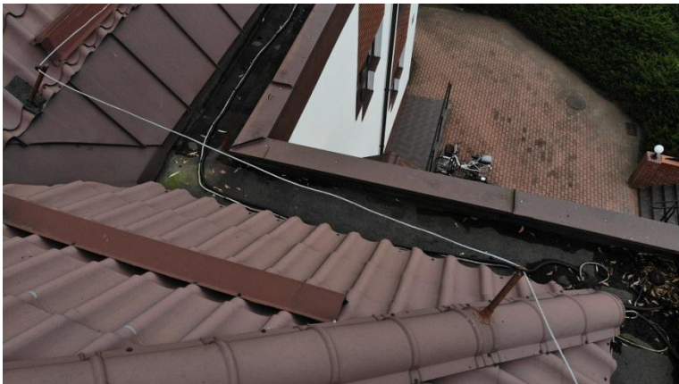
Kanał odpływowy nad pomieszczeniem 212 zdjęcie nr 2
