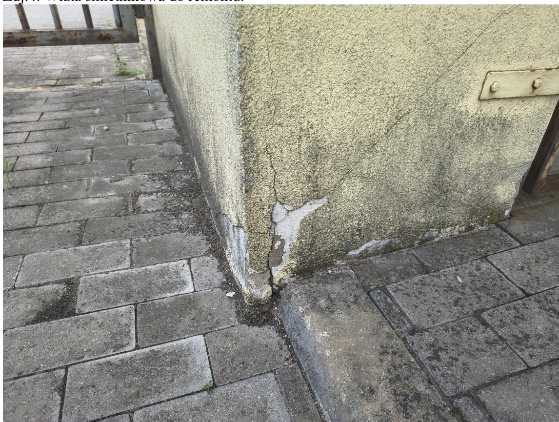
Zdj.5. Wiata śmietnikowa do remontu.
