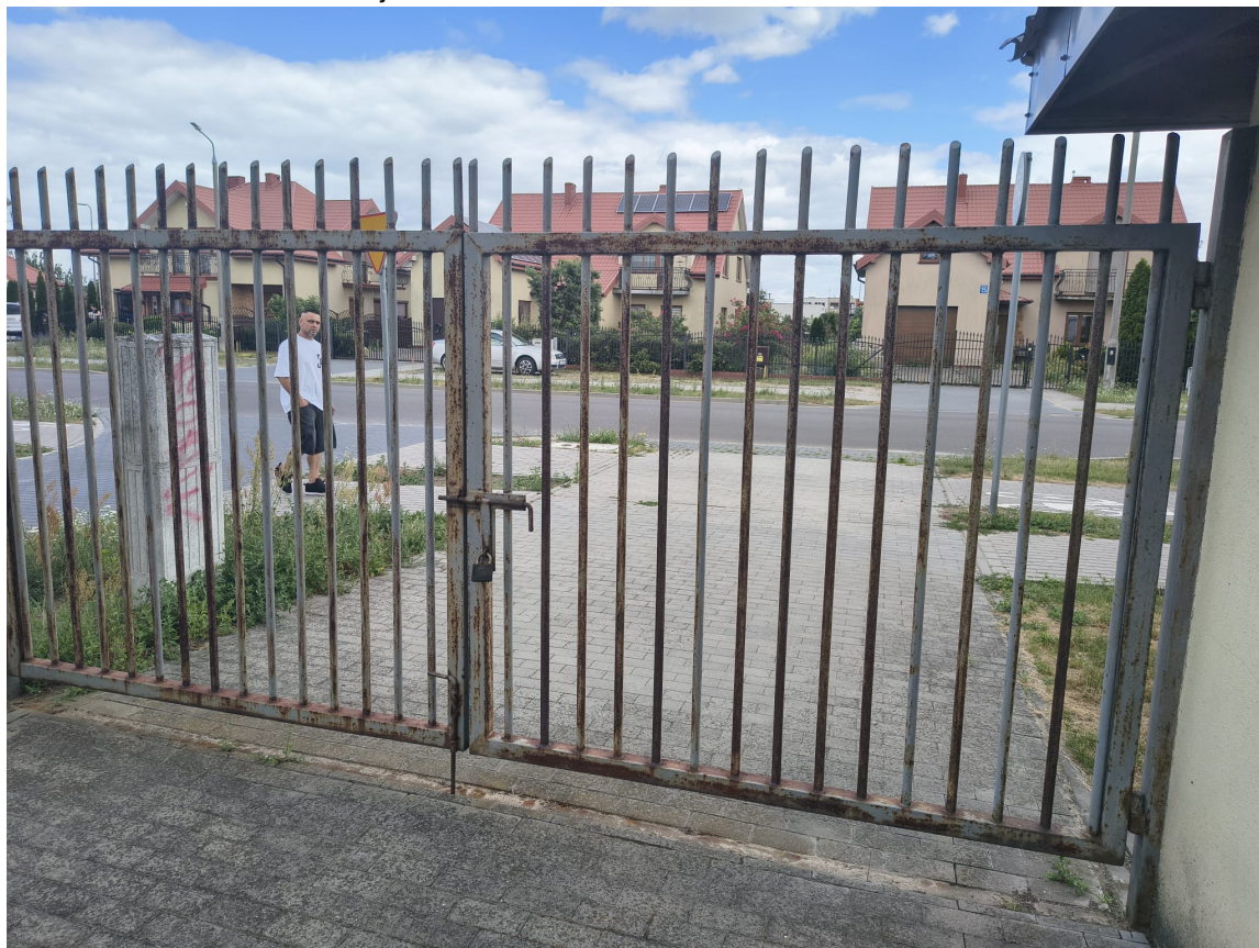
Zdj.2. Ogrodzenie do remontu.
