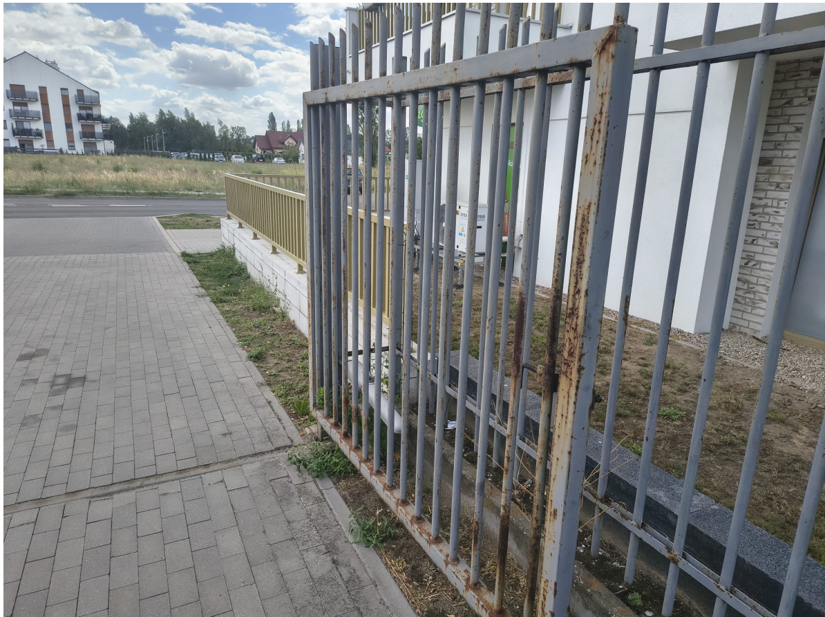
Zdj.1. Ogrodzenie do remontu.
