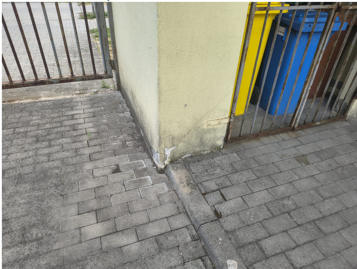
Zdj.4. Wiata śmietnikowa do remontu.
